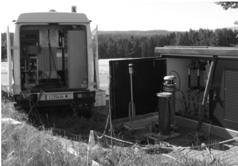
Abbildung: Mobiles Resonanzprüfsystem zur Teilentladungs- und Verlustfaktormessung und Spannungsprüfung
